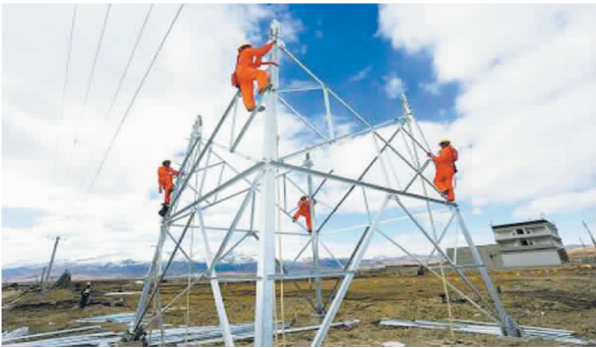
在海拔4000米的理塘高原,理塘至江达35KV输电工程项目在进行组塔施工。
