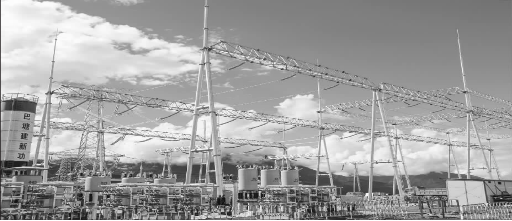
巴塘变电站一角。张涛 摄
