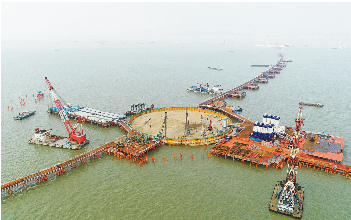
这是深中通道伶仃洋大桥东锚碇围堰施工现场。新华社发
