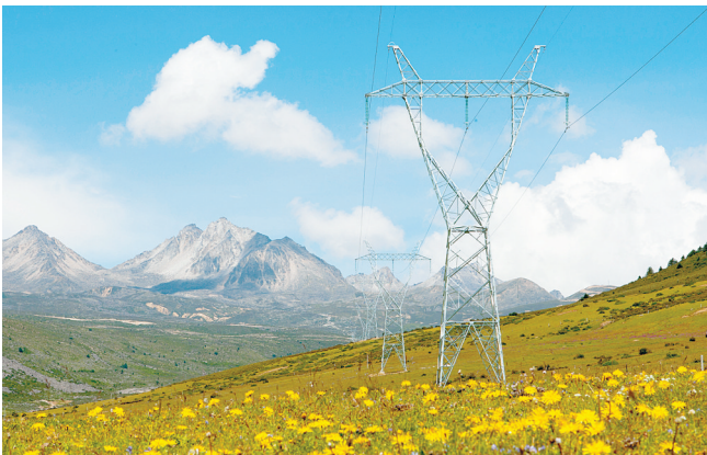
折多山上的输电铁塔。王明阳 摄
