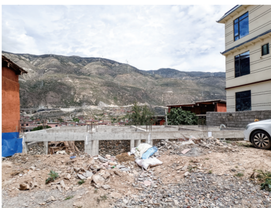
夏邛镇架地顶村房屋现场照片
